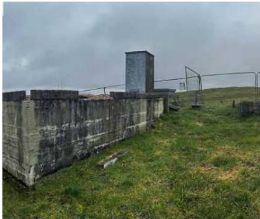
Existing Water Tank (D)
