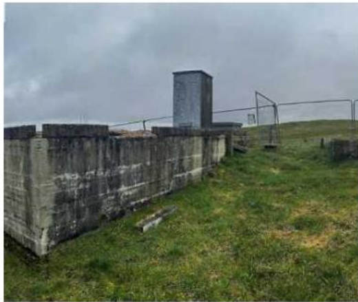
Existing Water Tank (D)
